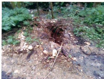
▲円能寺林道の陥没箇所
